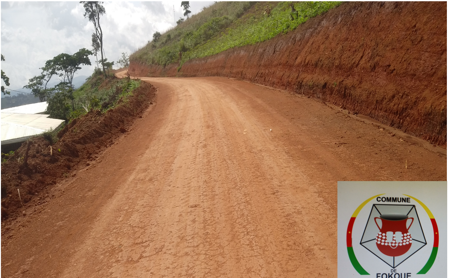
Un chantier routier à Fokoué. Image réalisée par la cellule de communication (Celcom) de la mairie
