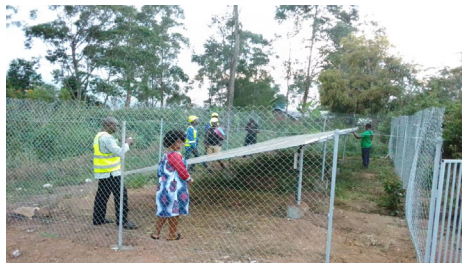
Mini centrale solaire. © Celcom
